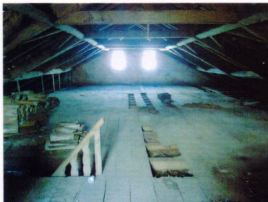
1 – Assoalho do sótão com buracos.
