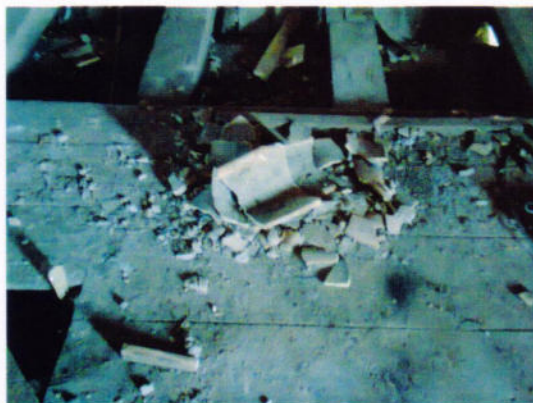
1 – Cacos das telhas originais.
