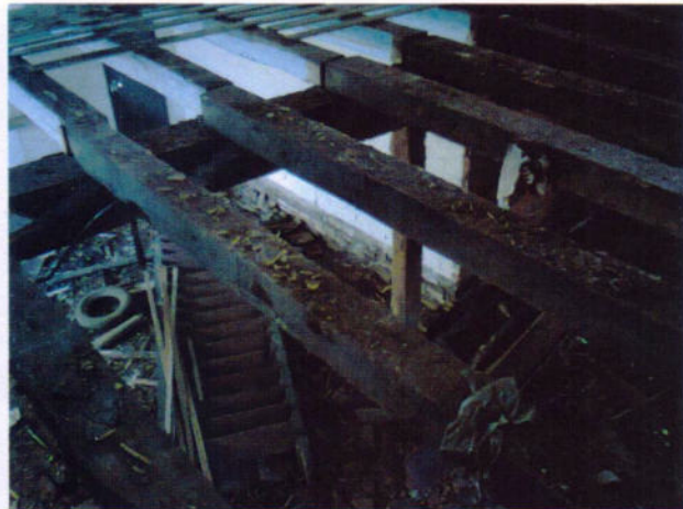
3 – Escada de acesso ao porão retirada quase inteira e jogada ao fundo do porão.
