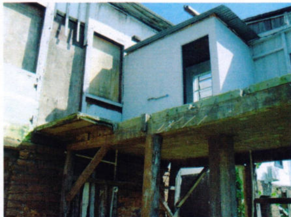
2 – Detalhe do acesso entre o salão e a cozinha fechado com tapume.
