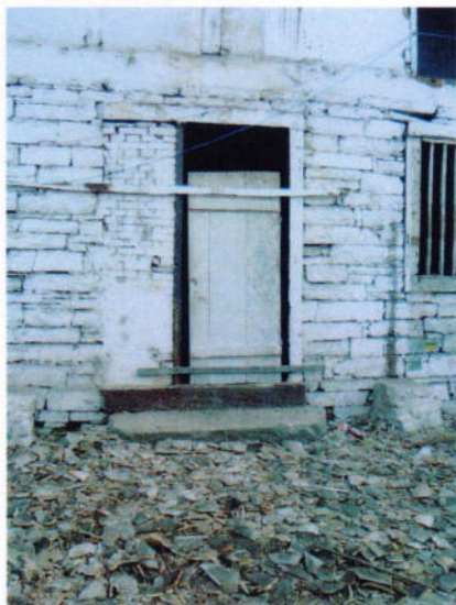
2 – Cacos de parte das telhas originais espalhadas no pátio.
