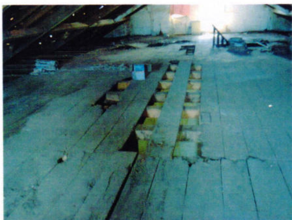
2 – Assoalho original com buracos.
